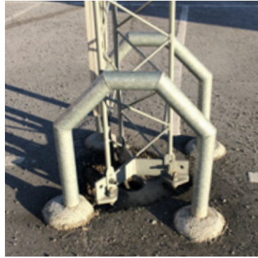
Dubbelmonterade vid belysningsmast
